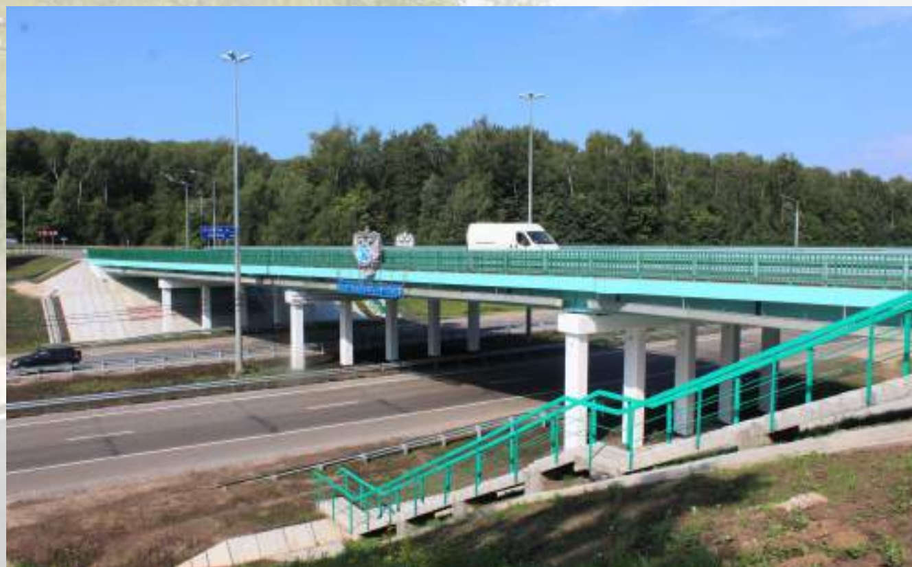
Отремонтированный путепровод через автомобильную дорогу на км 134 автомагистрали М-2 «Крым» в Тульской области
